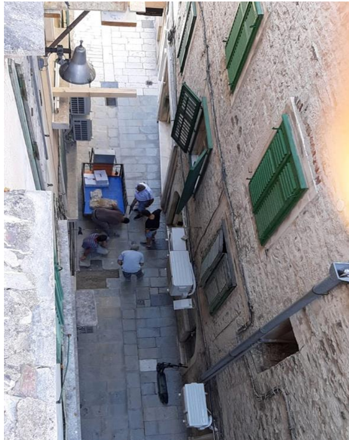
Slika 13 Izvođenje nedozvoljenih radova u Marulićevoj ulici. Izvor: https://www.dalmacijadanas.hr/nova-devastacija-splitske-stare-jezgre-nakon-bosanske-pikamerom-po-kamenim-plocama-jos-jedne-ulice-uz-palacu/ , pristupljeno dana: 17.07.2020.
