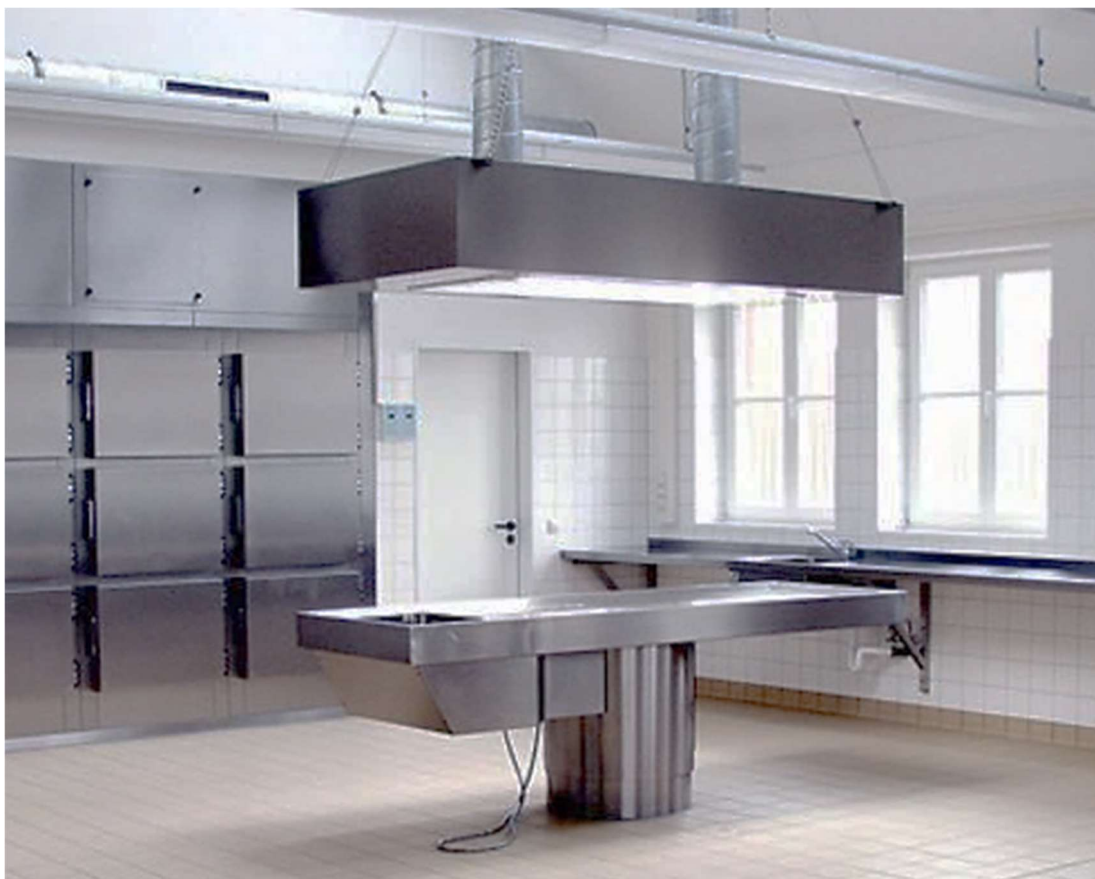
Slika 7. Sustav lokalne ventilacije i filtracije
